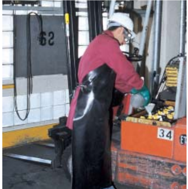
Abbildung 6: Bei Instandhaltungsarbeiten an den Traktionsbatterien ist aufgrund der Verätzungsgefahr geeignete Schutzkleidung zu tragen.
