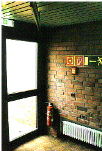
Bild 11-2: Notausgang in einem Verwaltungsgebäude mit Kennzeichnungen und Feuerlöscher
