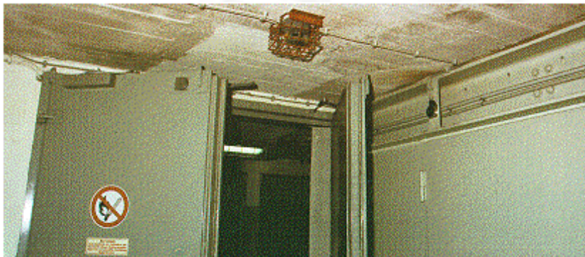
Bild 12-7: Meldergesteuertes Türmagnetsystem für selbstschließende Tür mit Schließfolgeeinrichtung als Brandabschluß für einen Raum zur Lagerung brennbarer Flüssigkeiten
