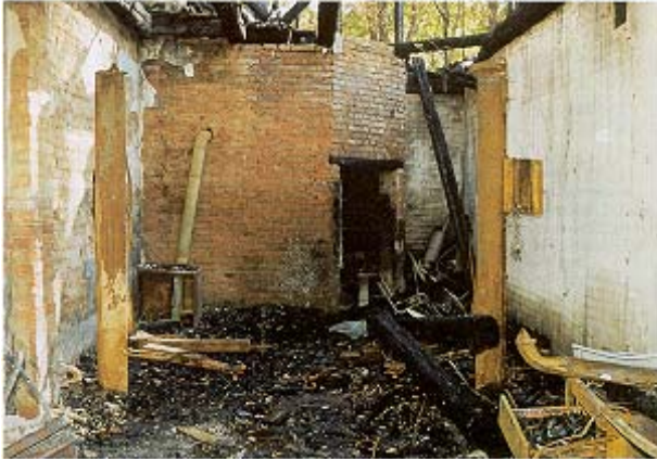
Bild 1-1: Durch Schweißarbeiten ausgebrannte Kfz-Werkstatt
