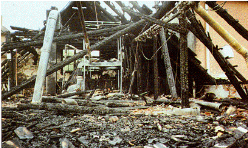
Bild 2-2: Absauganlage und Modellboden durch Brand zerstört
