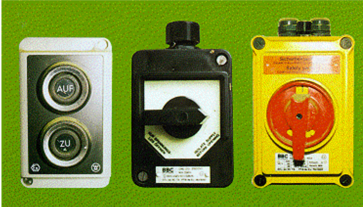
Bilder 11-9 und 11-10: In feuer- und explosionsgefährdeten Bereichen müssen die Elektroinstallationen besonderen Anforderungen genügen
