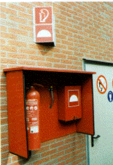
Bild 12-20: Feuerlöscher und Löschdecke im Betrieb
