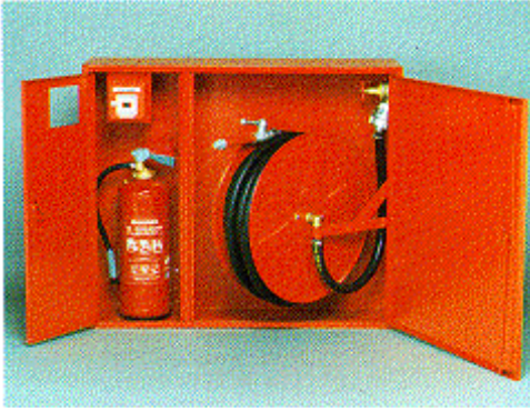
Bild 12-19: Wandhydrant mit formbeständigem Schlauch, Pulverlöscher und Feuermelder
