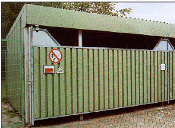
Bild 11-15: Oberirdische Lagerung leicht entzündlicher Gase
