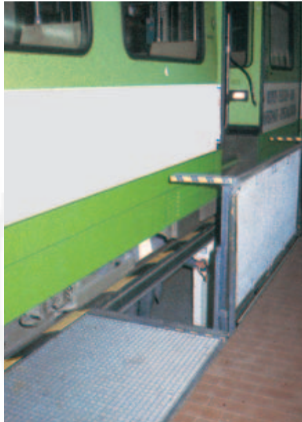
Bild 4-8: Lange Arbeitsgrube in einer Straßenbahnbetriebswerkstatt
