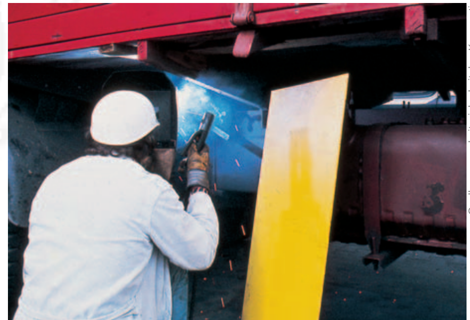
Bild 5-9: Gegen Funkenflug und Strahlungswärme abgedeckter Kraftstofftank beim Schweißen an Fahrzeugen
