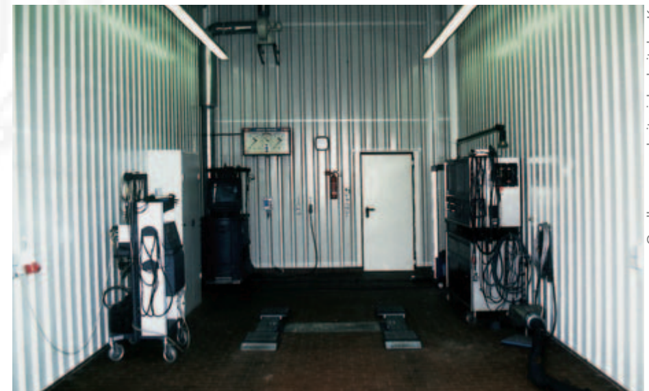
Bild 15-1: Vorbildlicher Prüfstandsraum mit schallabsorbierenden Wand- und Deckenflächen
