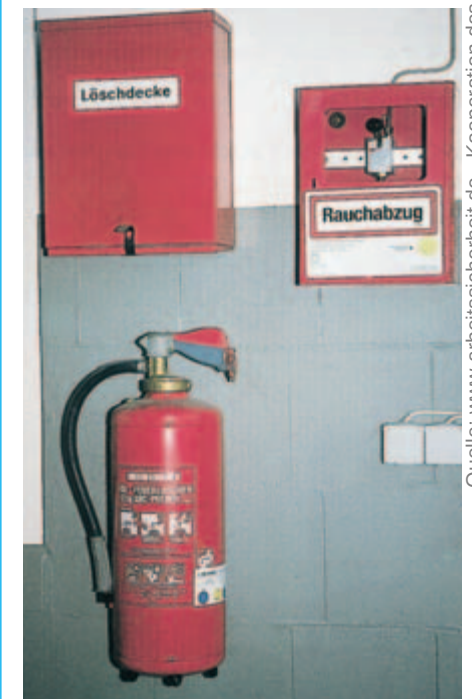
Bild 5-18: Frei zugänglicher Handfeuerlöscher mit Löschdecke und anderen Löscheinrichtungen
