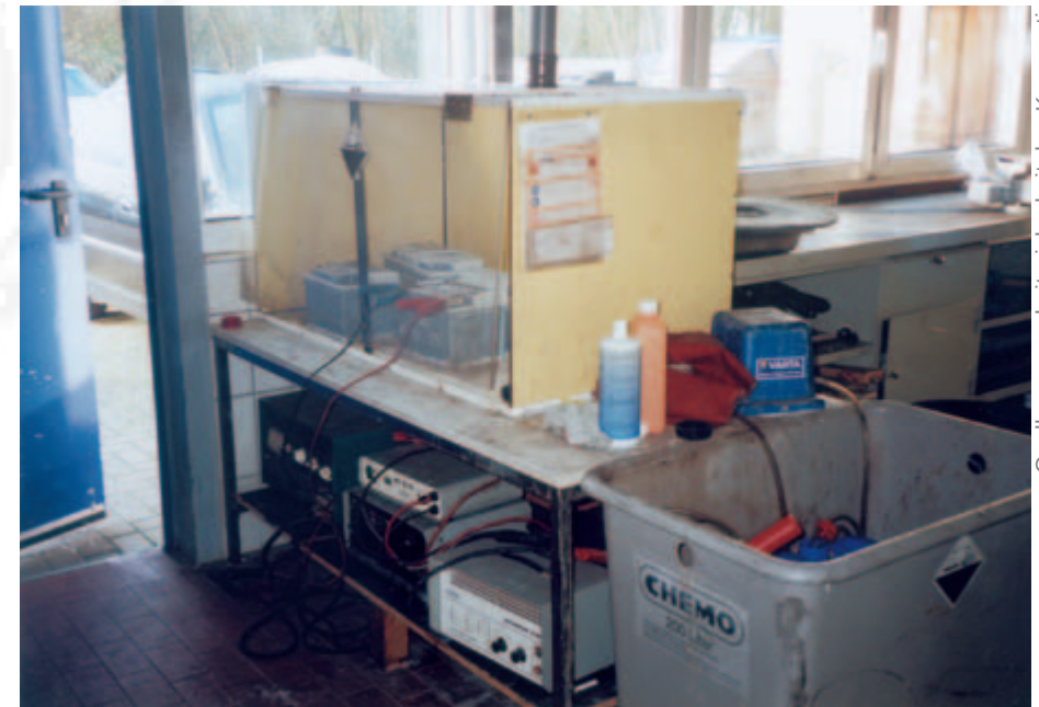
Bild 5-12: Batterieladeeinrichtung „Eigenbau“ mit Entlüftung
