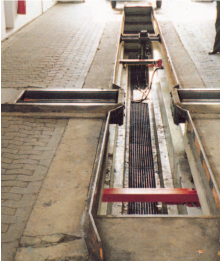
Bild 12-2: Sicherung des Gefahrenbereiches in der Arbeitsgrube durch klappbare elektrooptische Einrichtung. (An dem über die Fahrbahn hinausragenden Rollensatz fehlt der Warnanstrich)
