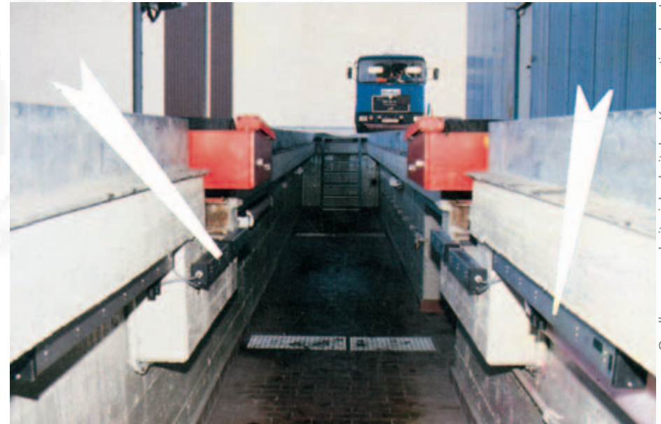
Bild 12-3: Sicherung des Gefahrenbereiches in der Arbeitsgrube durch feststehende elektrooptische Einrichtung
