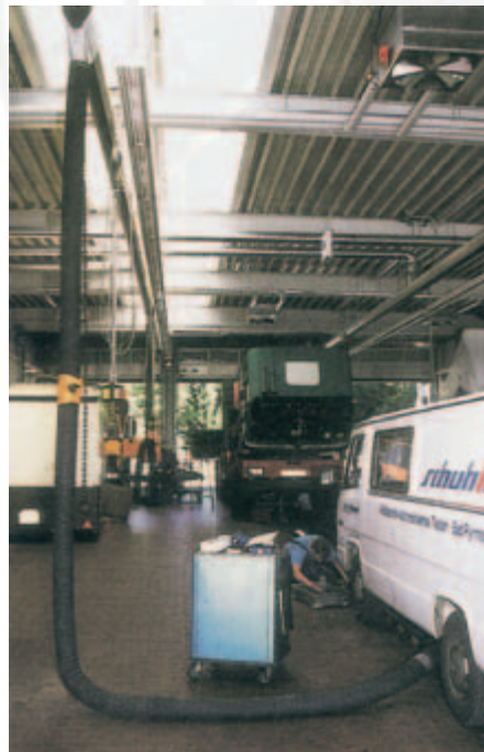
Bild 15-2: Abgasabsaugung mit oberirdischer Anlage
